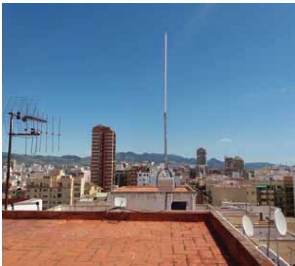
FIGURA 4. Gateway LoRaWAN instalado en Castellón.
